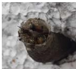
Figura 10. Entrada do ninho da espécie Jataí ( Tetragonisca angustula ) em parede de concreto na cidade de São Paulo.
